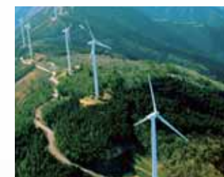
葉山風力発電所 (2万kW)
